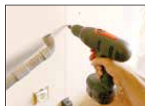
Ligne de vissage Screwing line
